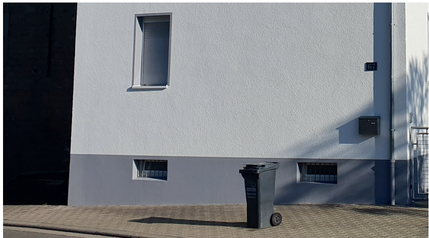
Modernisierungs- und Instandsetzungsbedürftiges Gebäude mit geringem Bedarf
