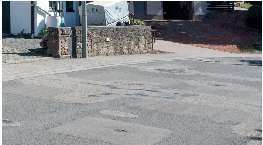
Misstand: Sanierungsbedürftige Fahrbahndecke mit notdürftigen Ausbesserungen (Olsbrücker Straße)
