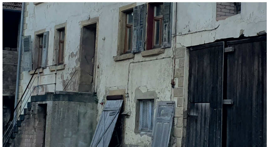
Modernisierungs- und instandsetzungsbedürftiges Gebäude mit hohem Bedarf
