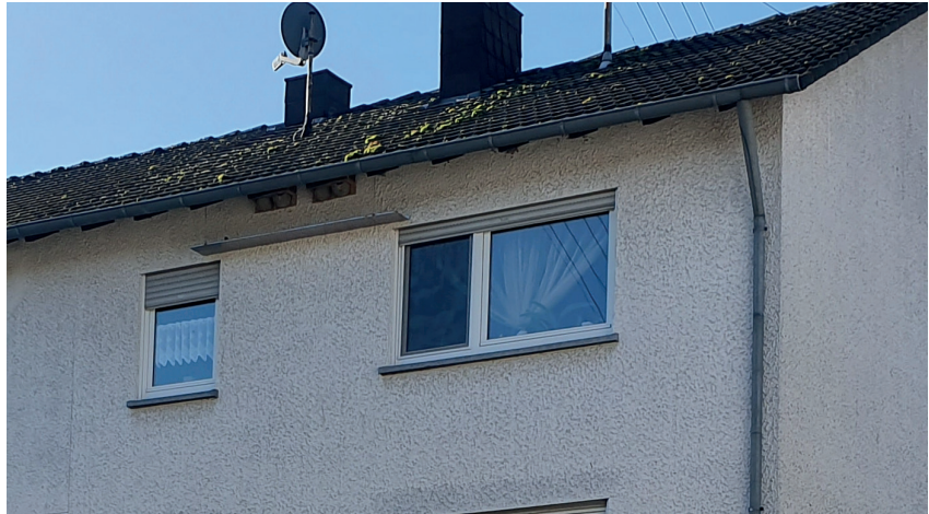
Modernisierungs- und Instandsetzungsbedürftiges Gebäude mit mittlerem Bedarf
