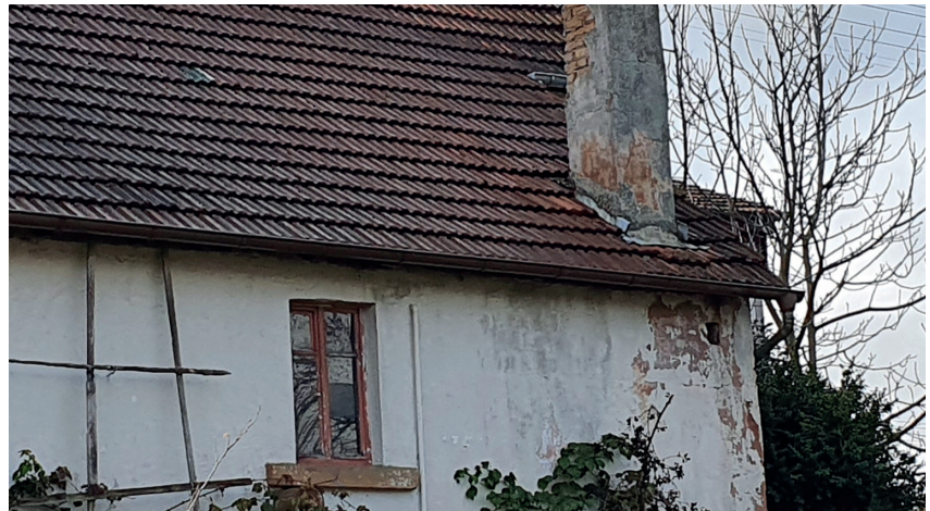
Modernisierungs- und instandsetzungsbedürftiges Gebäude mit hohem Bedarf
