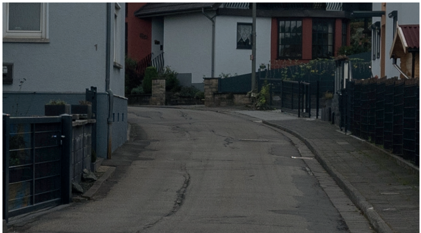
Misstand: sanierungsbedürftige Fahrbahndecken im Bereich der Flurstraße
