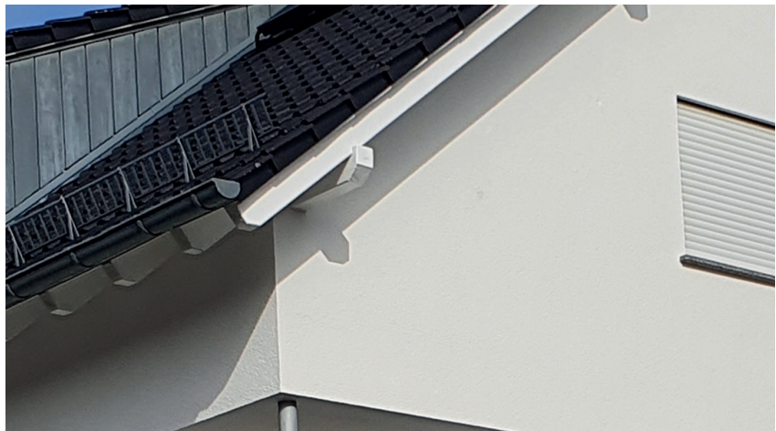
Modernisierungs- und instandsetzungsbedürftiges Gebäude mit geringem Bedarf
