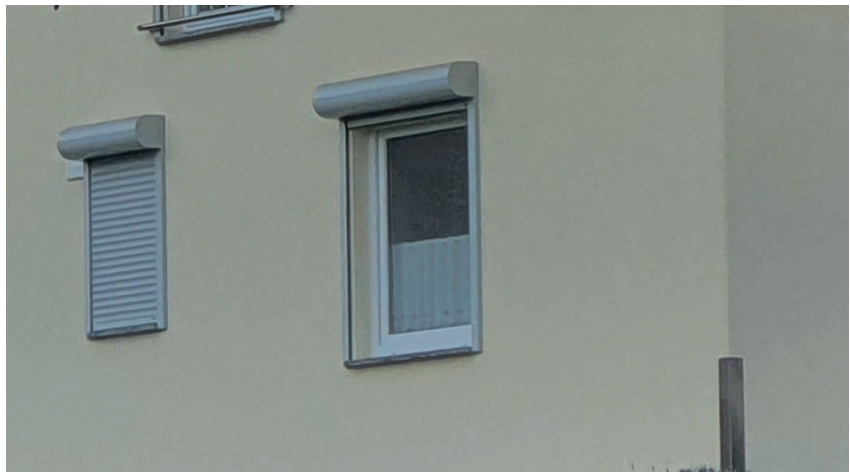
Modernisierungs- und instandsetzungsbedürftiges Gebäude mit geringem Bedarf
