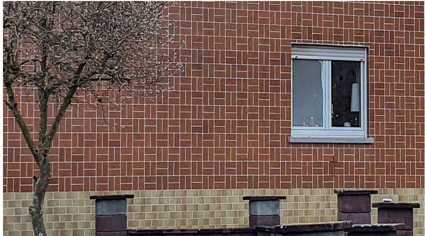
Missstand Beispiel: nicht ortsbildgerechte Materialität der Fassade
