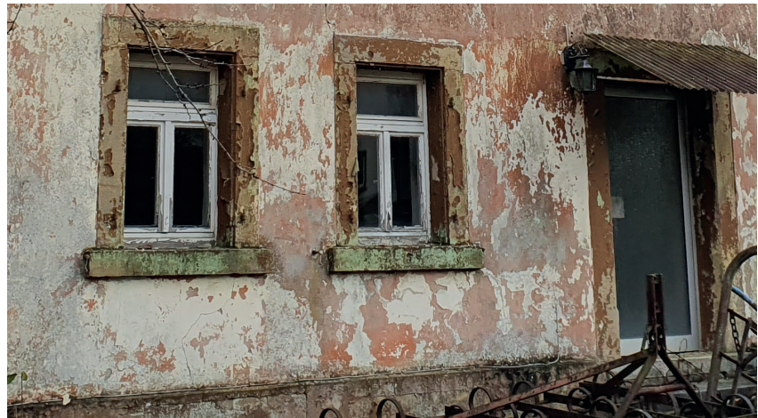
Modernisierungs- und instandsetzungsbedürftiges Gebäude mit hohem Bedarf
