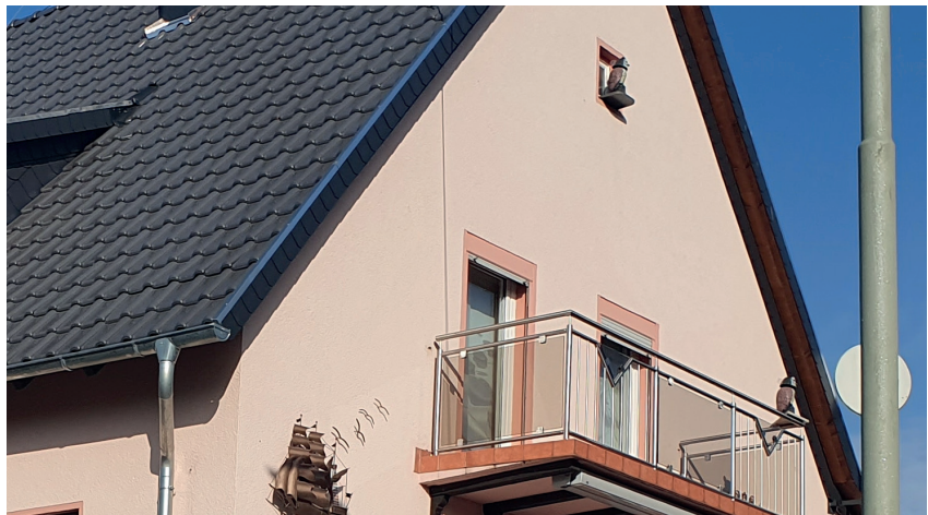
Modernisierungs- und instandsetzungsbedürftiges Gebäude mit geringem Bedarf
