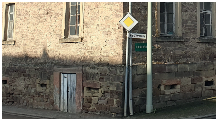
Modernisierungs- und instandsetzungsbedürftiges Gebäude mit hohem Bedarf
