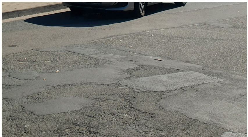
Misstand: Sanierungsbedürftige Fahrbahndecke mit notdürftigen Ausbesserungen (Talstraße)
