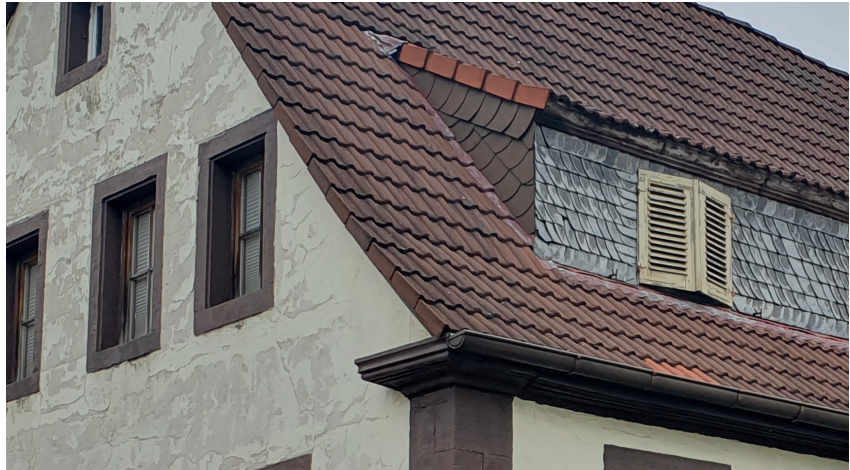
Modernisierungs- und instandsetzungsbedürftiges Gebäude mit mittlerem Bedarf
