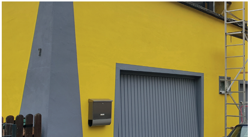
Missstand Beispiel: nicht ortsbildgerechte Farbgestaltung der Fassade
