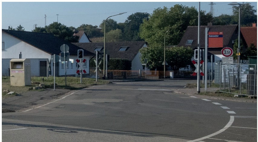
Missstand: fehlende Beschränkung des Bahnübergangs, sanierungsbedürftige Fahrbahndecke
