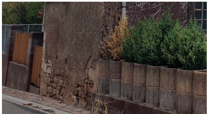
Modernisierungs- und instandsetzungsbedürftiges Gebäude mit hohem Bedarf
