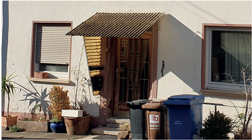
Modernisierungs- und Instandsetzungsbedürftiges Gebäude mit mittlerem Bedarf
