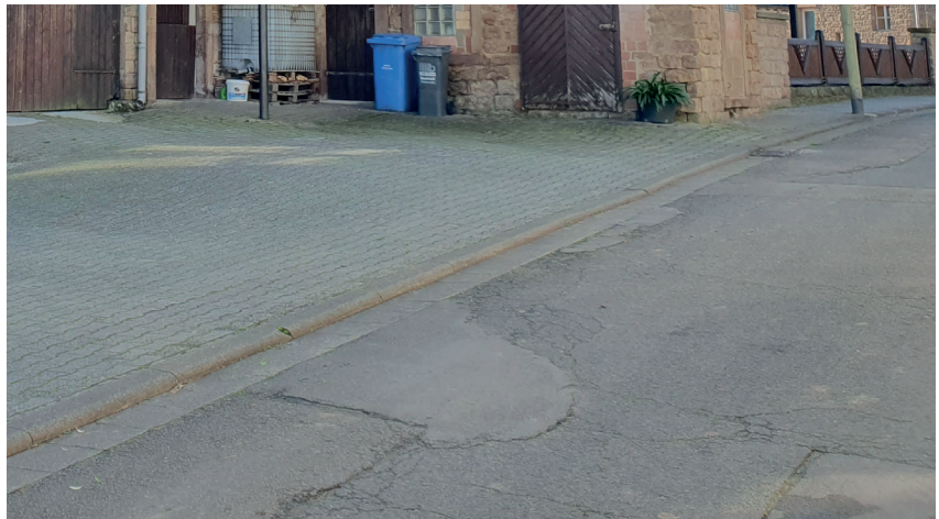
Misstand: Sanierungsbedürftige Fahrbahndecke mit notdürftigen Ausbesserungen (Im Hofeck)
