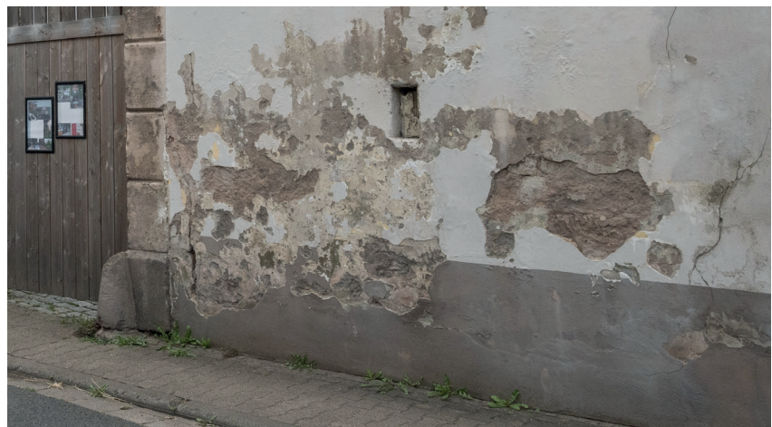
Modernisierungs- und instandsetzungsbedürftiges Gebäude mit hohem Bedarf
