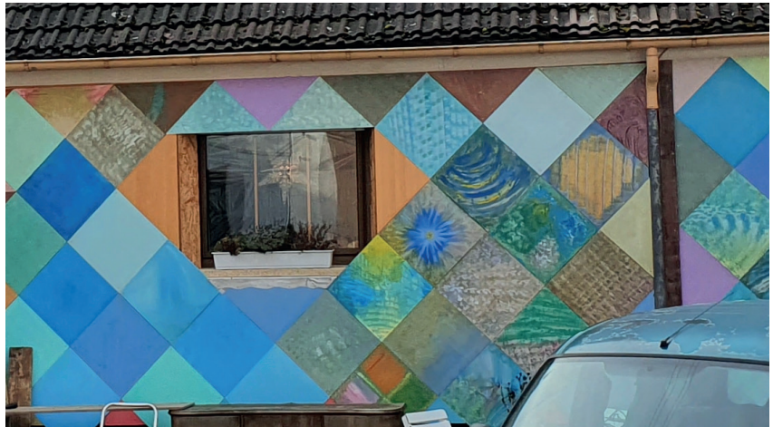
Missstand Beispiel: nicht ortsbildgerechte Materialität und Farbgestaltung der Fassade
