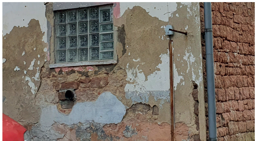
Modernisierungs- und instandsetzungsbedürftiges Gebäude mit hohem Bedarf
