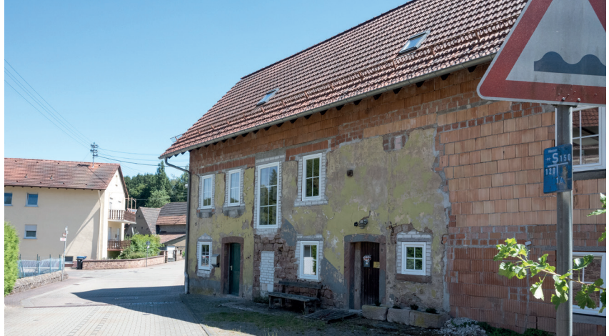
Missstand Beispiel: Materialität der Fassade (fehlender Putz)
