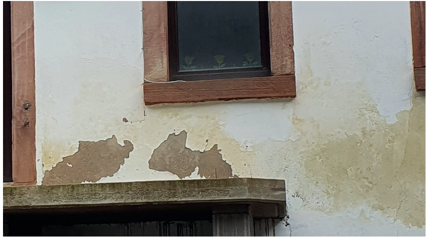
Modernisierungs- und instandsetzungsbedürftiges Gebäude mit mittlerem Bedarf
