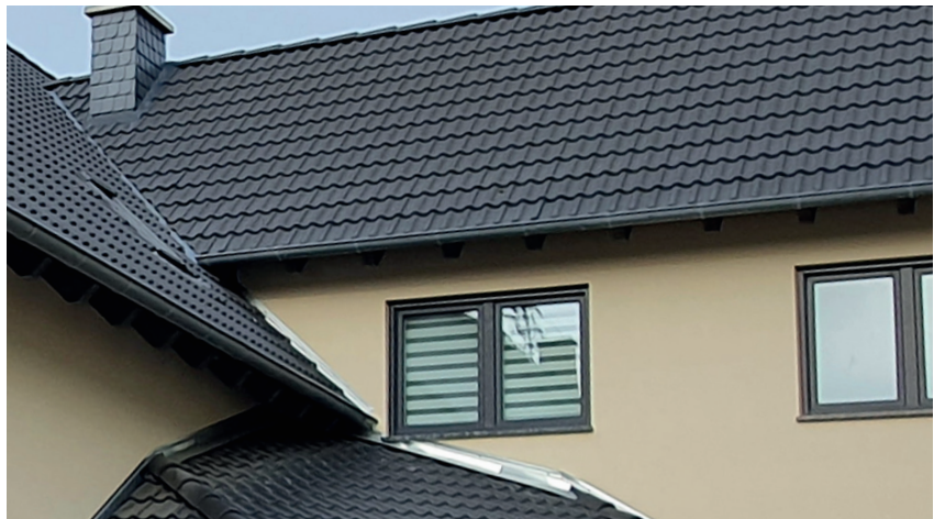
Modernisierungs- und instandsetzungsbedürftiges Gebäude mit geringem Bedarf
