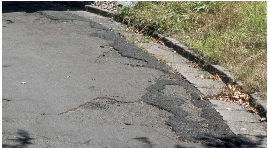
Misstand: sanierungsbedürftige Fahrbahndecken im Bereich der Bergstraße
