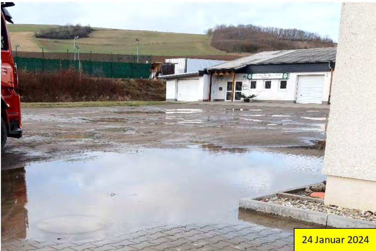
Abb. 170: Parkplatz vor der überflutungsgefährdeten Westpfalzhalle, Foto: Ortsgemeinde
