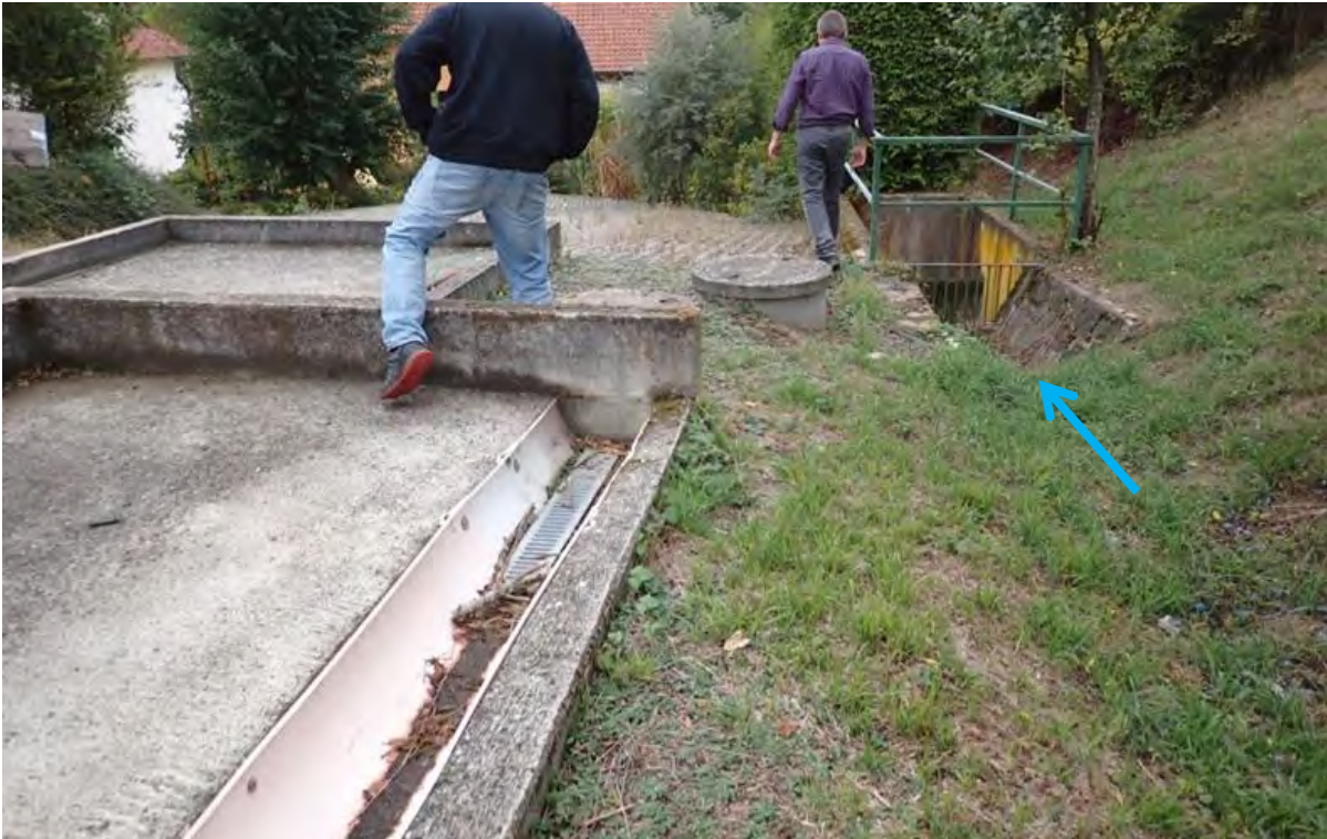
Abb. 129: Bei Starkregen überlastetes Entwässerungssystem
