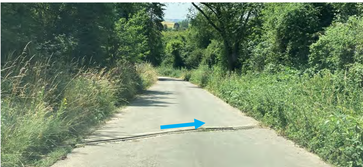
Abb. 101: Weg zur Hebelstraße mit Querrinne
