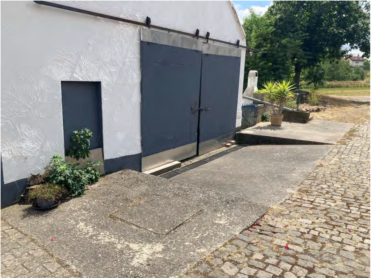
Abb. 205: Beispiel für potenziell überflutungsgefährdetes Gebäude in der Weiherstraße
