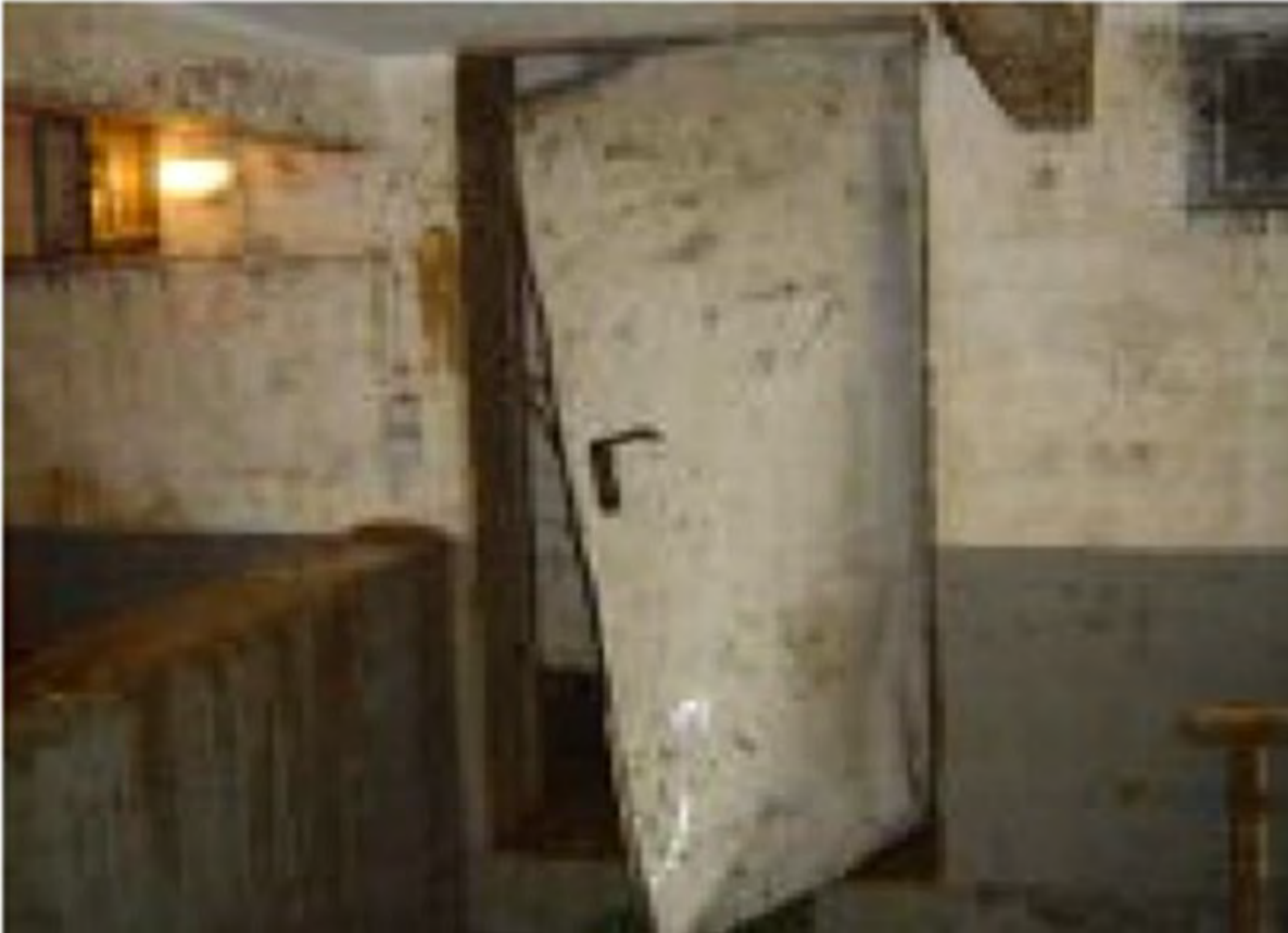
Abb. 104: Zerstörung in einem Keller bei Starkregen 2021, Foto Feuerwehr
