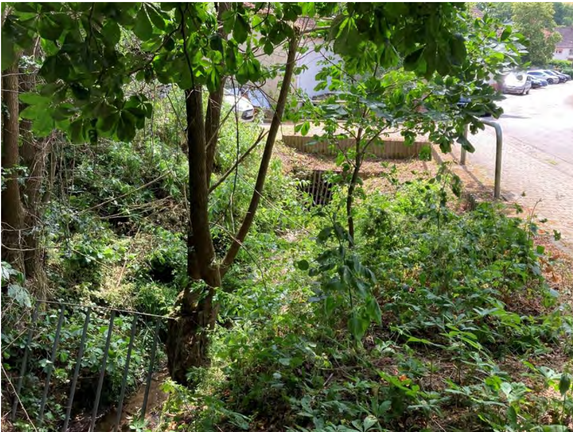
Abb. 154: Rechen zum Treibgutrückhalt vor der Bornbachverrohrung
