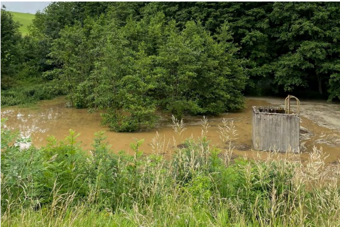
Abb. 161: Regenrückhaltebecken Selinger Tal bei Starkregen 2003, Foto: Feuerwehr
