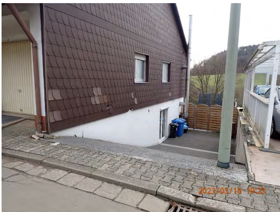
Abb. 13: Beispiel für überflutungsgefährdete tiefliegende Gebäudeteile
