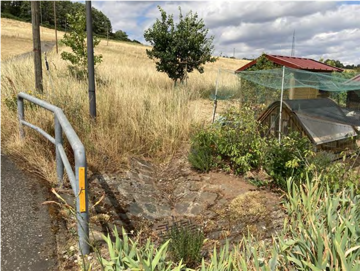
Abb. 187: Muldenablauf am nordwestlichen Bebauungsrand
