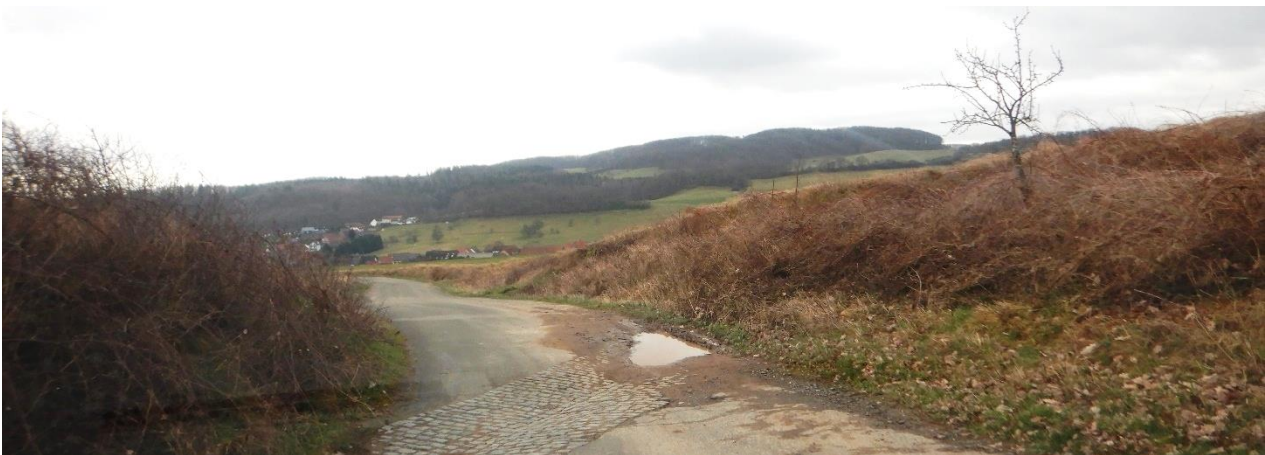
Abb. 12: Querrinne im Wirtschaftsweg zur Bergstraße mit fehlender Vorflut
