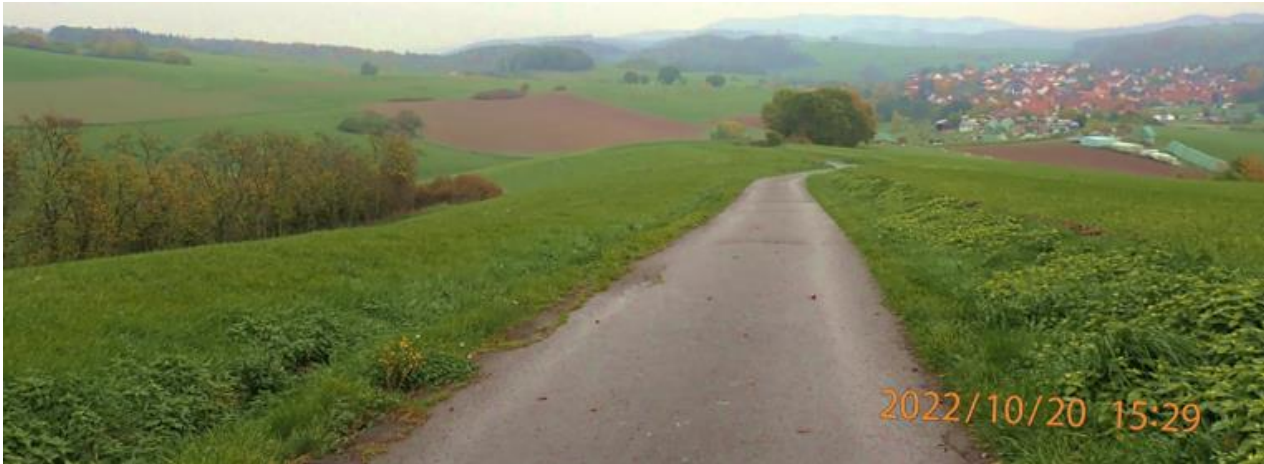
Abb. 7: Weg vom Erlenberg zur Stockwaldstraße mit Potenzial zur Querentwässerung durch Abschieben der Bankette
