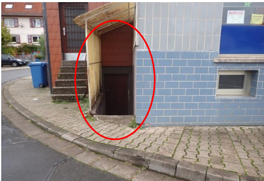
Abb. 43: Stark überflutungsgefährdeter, außenliegender Kellerabgang
