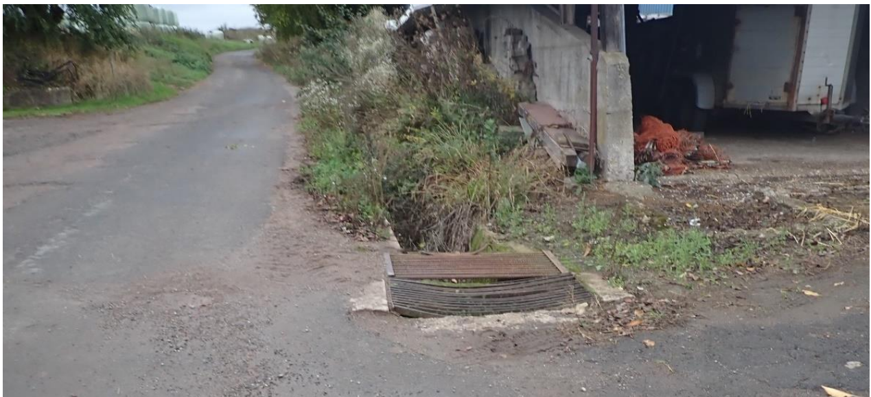
Abb. 10: Wegseitengraben und Sandfang mit Unterhaltungsbedarf in der Stockwaldstraße
