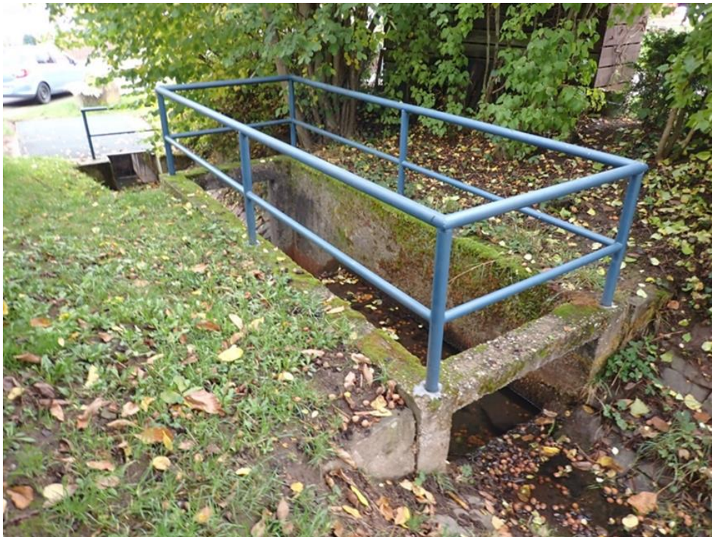
Abb. 63: Zulauf zur Bachverrohrung als kritische Engstelle
