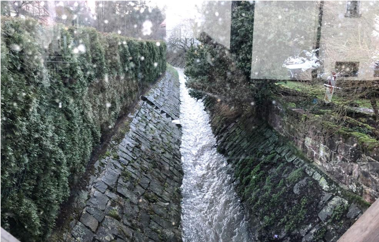
Abb. 89: Überflutungsgefährdete Nutzungen am Sulzbach an der Hauptstraße
