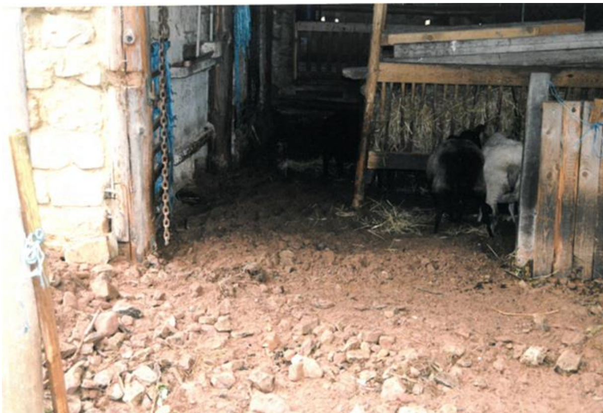
Abb. 70: Zerstörung eines Stalls im Außenbereich, Foto: Gehm
