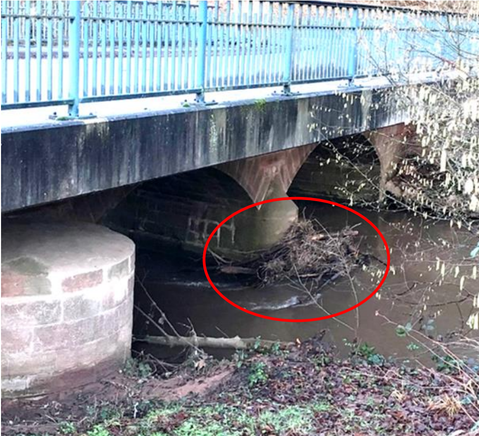
Abb. 30: Beginnende Verklausung an der Brücke Hauptstraße, 01/2022
