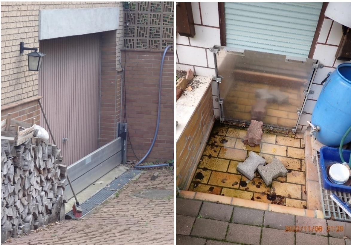
Abb. 21: Dammbalkenverschluss (links) und Schott (rechts)
