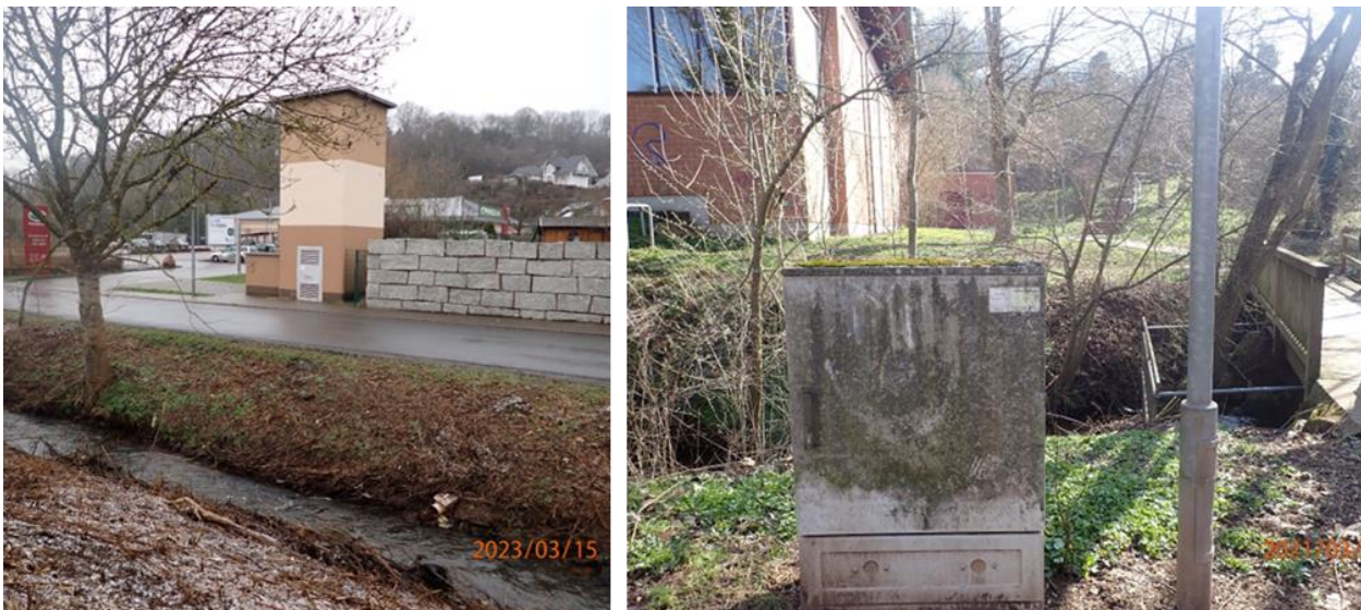
Abb. 5: Beispiele für überflutungsgefährdete Stromversorgungseinrichtungen am Otterbach
