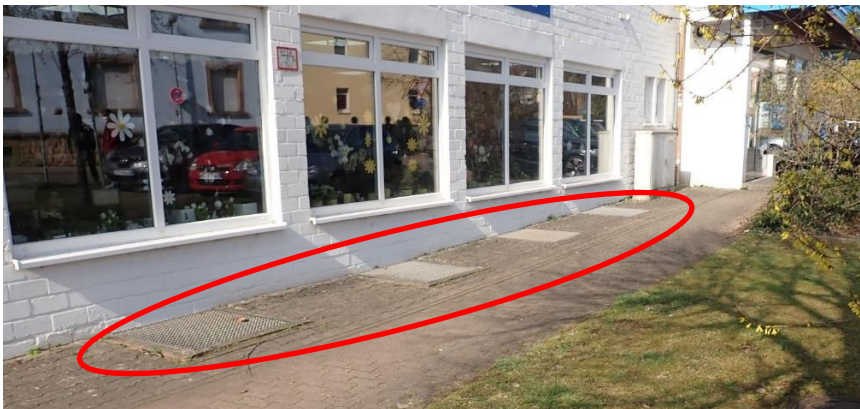
Abb. 20: Beispiel für ungeschützte Lichtschächte im überflutungsgefährdeten Bereich in Otterberg
