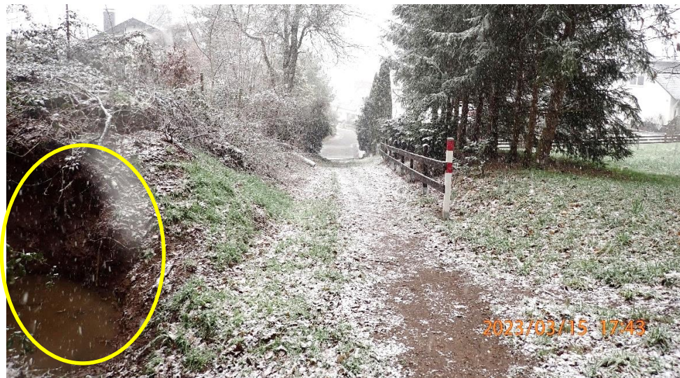
Abb. 176: Beispiel für Kleinrückhalt am Forstweg zur Baumstraße
