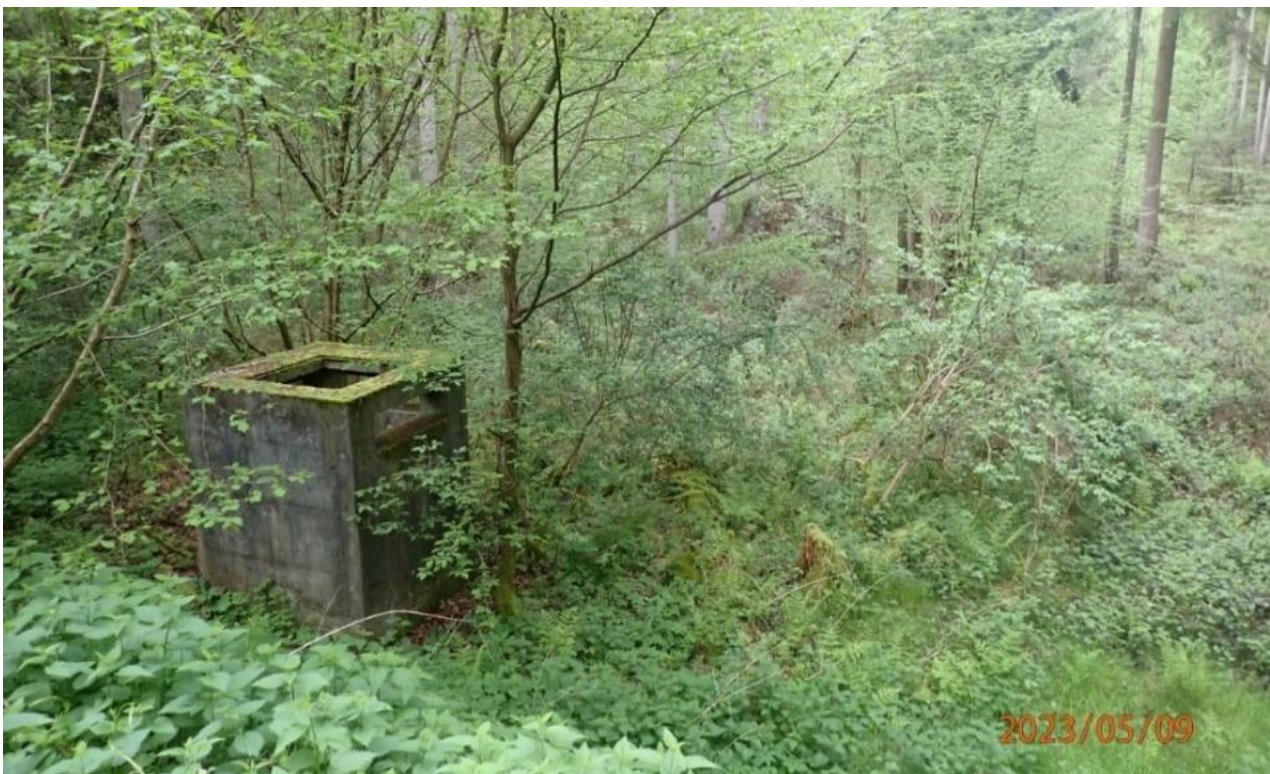
Abb. 48: Stark bewachsenes Hochwasserrückhaltebecken mit Mönchbauwerk
