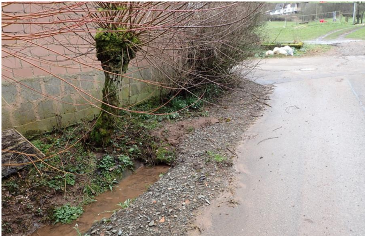
Abb. 242: Versandeter Flutgraben unterhalb des Straßendurchlasses
