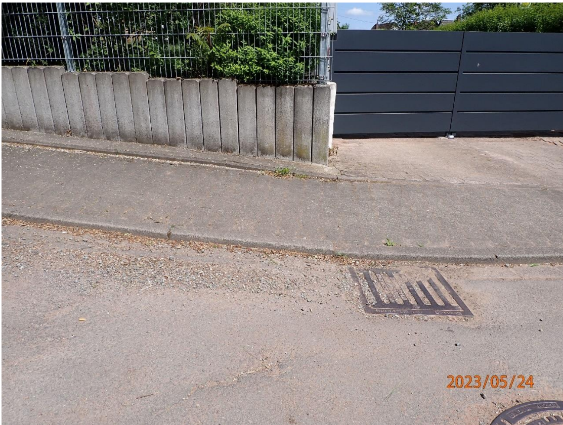
Abb. 194: Unterhaltungsbedürftiger Sandfang und Straßenablauf in der Waldstraße
