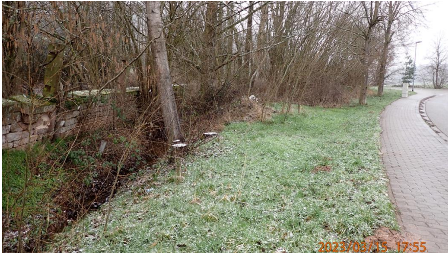
Abb. 184: Einsturzgefährdete Mauer im 10-m-Bereich des Katzenwoogbachs
