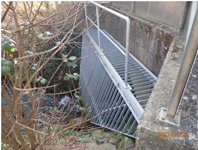
Abb. 143: Rechen am Beginn der Otterbachverrohrung oberhalb des Fachmarktes in der Bachstraße
