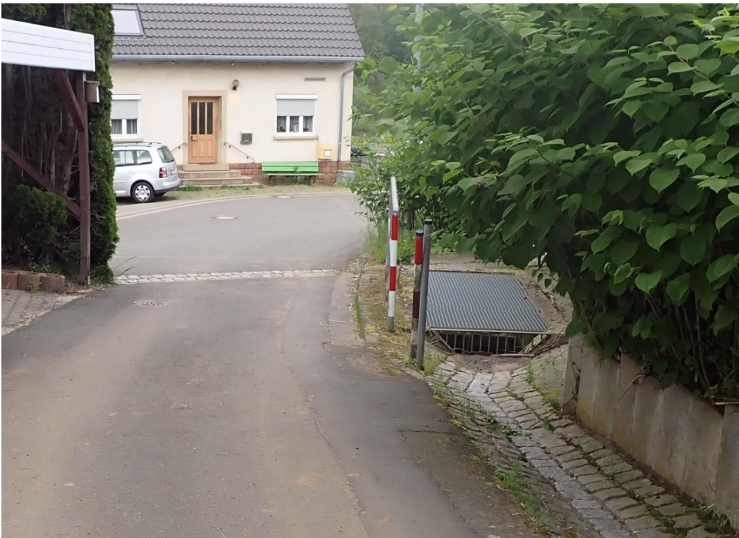
Abb. 238: Sandfang in der südlichen Tiefenlinie auf dem Reichenbacherhof
