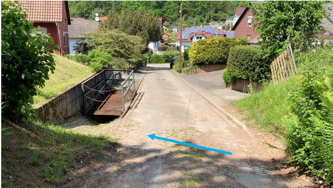
Abb. 218: Querrinne mit Sandfang in der Eckstraße
