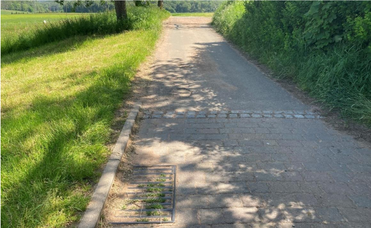
Abb. 251: Zugesetzter Straßenablauf am Bebauungsrand
