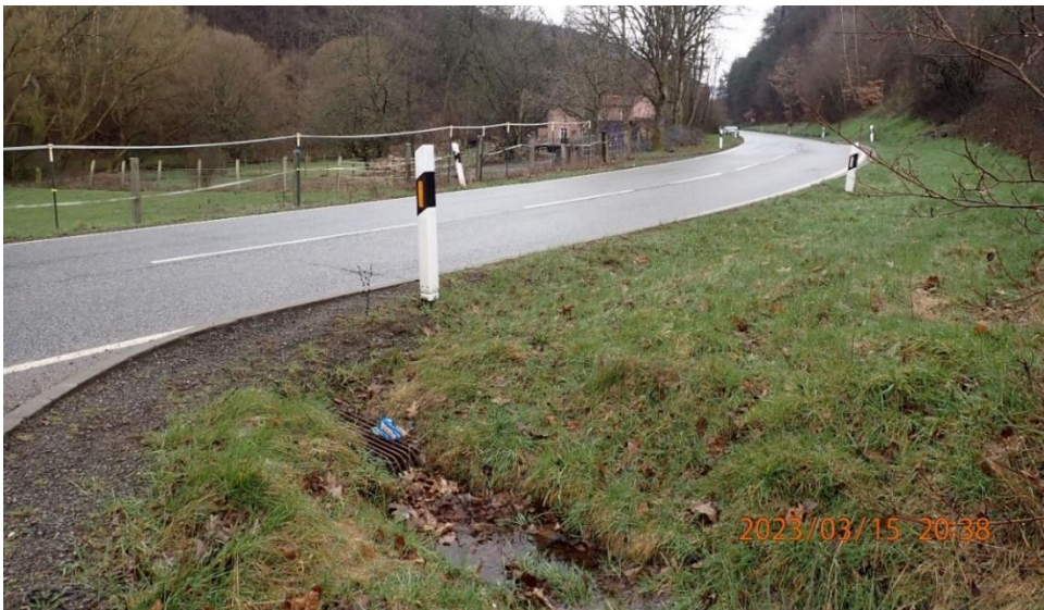
Abb. 39: Überstaugefährdeter Zulauf in den Straßendurchlass unterhalb des Campingplatzes
