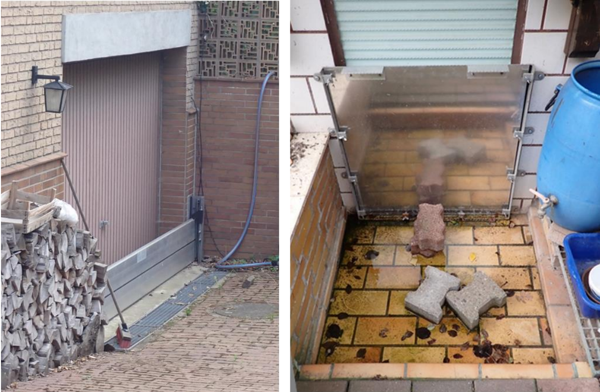
Abb. 27: Dambalkenverschluss (links) und Schott (rechts)
