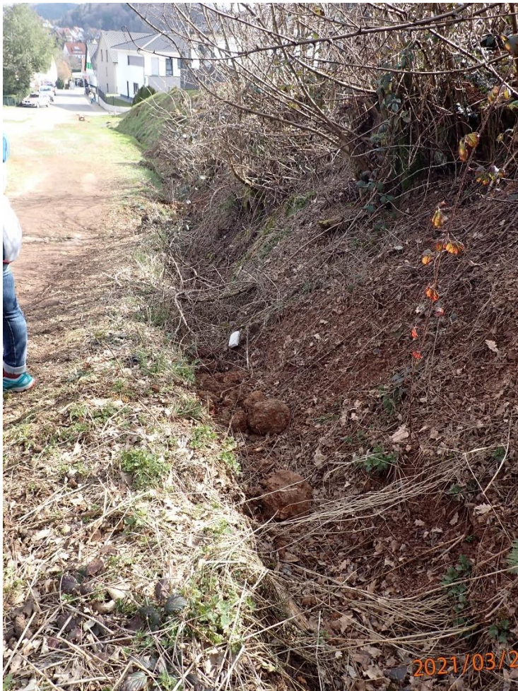
Abb. 117: Erosionsgefährdeter Wegseitengraben zur Kanalstraße
