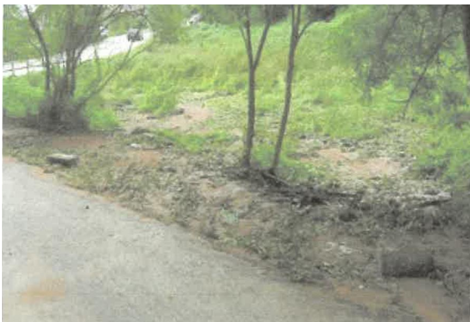
Abb. 154: Zufluss in die Geländemulde an der Althütter Straße bei Starkregen 2010, Foto: Fam. Markus
