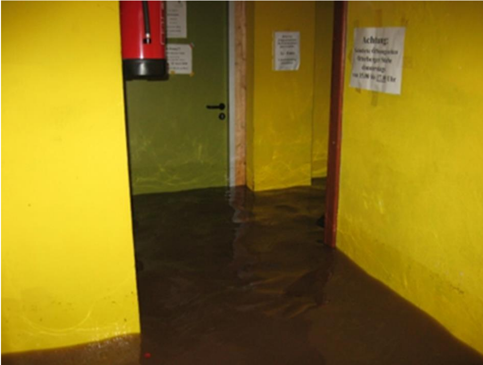
Abb. 145: Überschwemmter Keller der Grundschule, 2009, Foto: Feuerwehr
