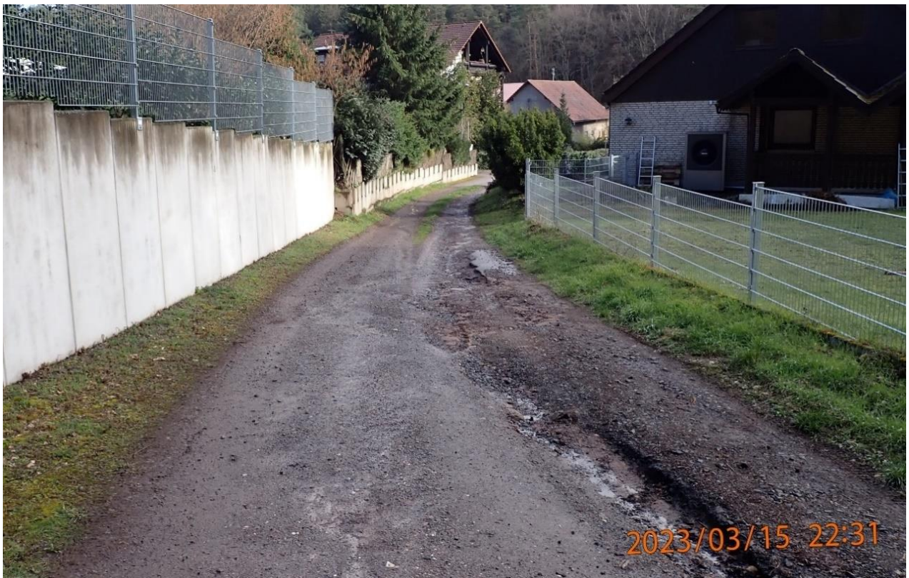
Abb. 226: Erosionsrinnen im Wirtschaftsweg „Am Frohnberg“
