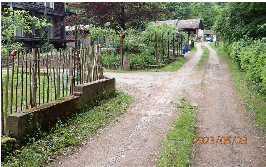
Abb. 156: Weg Dreibrunnen mit Potenzial zur Querentwässerung
