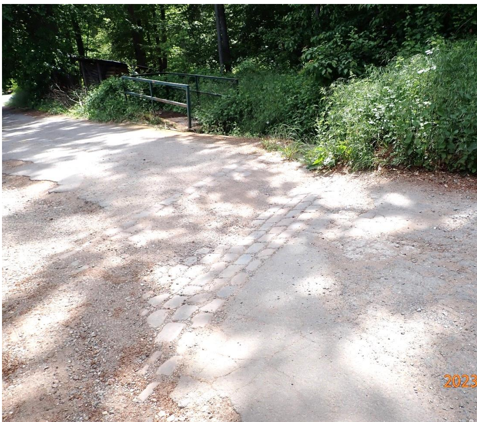
Abb. 193: Querrinne mit Sandfang in der Waldstraße
