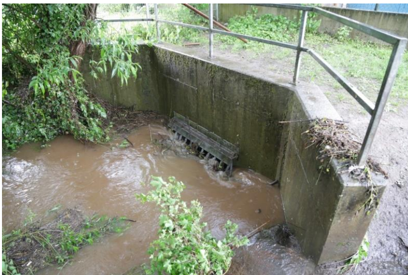
Abb. 141: Beginn der Verrohrung unter dem Fachmarkt bei Hochwasser 2016, Foto: Feuerwehr
