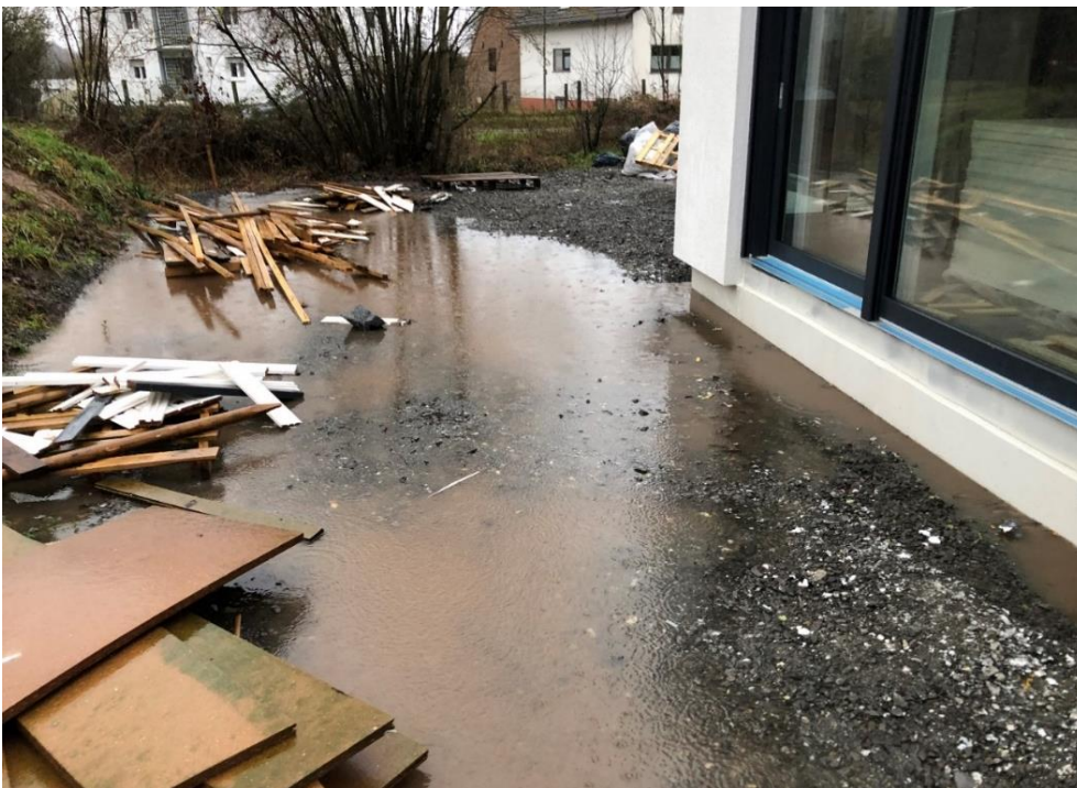
Abb. 98: Überflutetes Grundstück nach einem Starkregen 2021, Foto: Heintz
