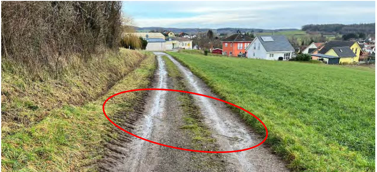
Abb. 83: Querrinne ohne Vorflut im unbefestigten Weg
