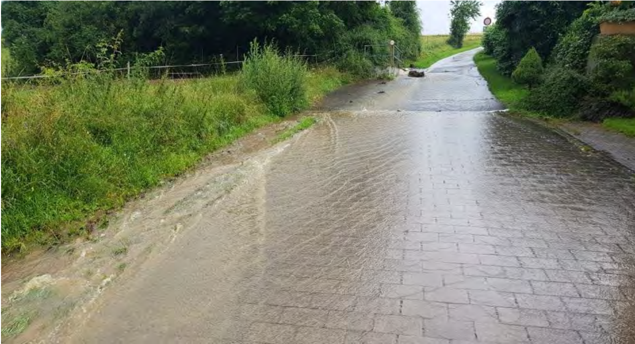
Abb. 49: Oberflächenabfluss auf dem Wirtschaftsweg vom Galgenberg zur Flurstraße, Foto: Rösner
