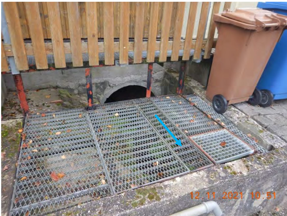
Abb. 113: Überbauung der Baierbachverrohrung unterhalb des Parkplatzes der Mehrzweckhalle und des anschließenden offenen Grabens
