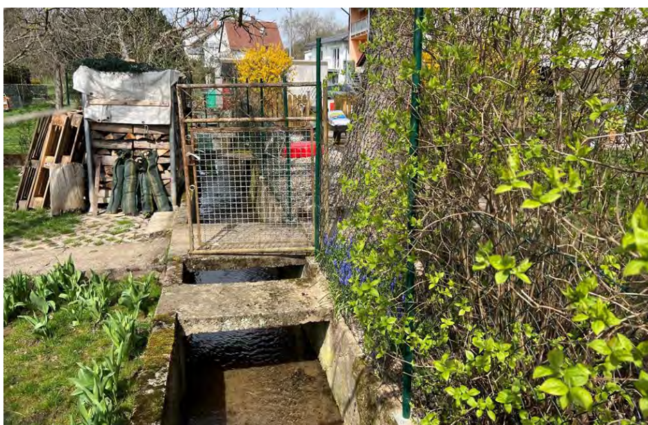
Abb. 115: Kritische Abflusshindernisse im Baierbach oberhalb der Querung der K 31
