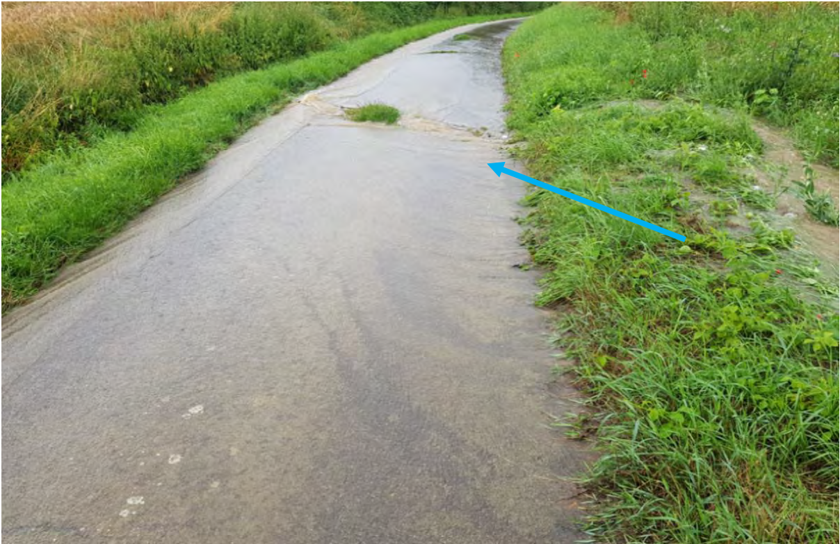
Abb. 60: Überströmte Querrinne bei dem Starkregenereignis 2021, Foto: Rösner
