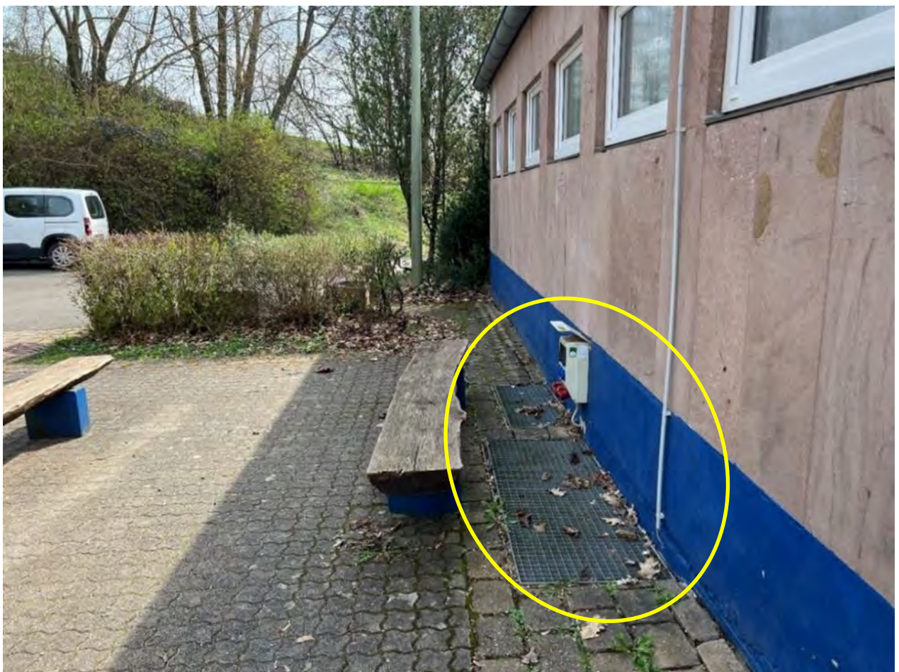
Abb. 122: Überflutungsgefährdete Lichtschächte und Technikinstallation an der Schule
