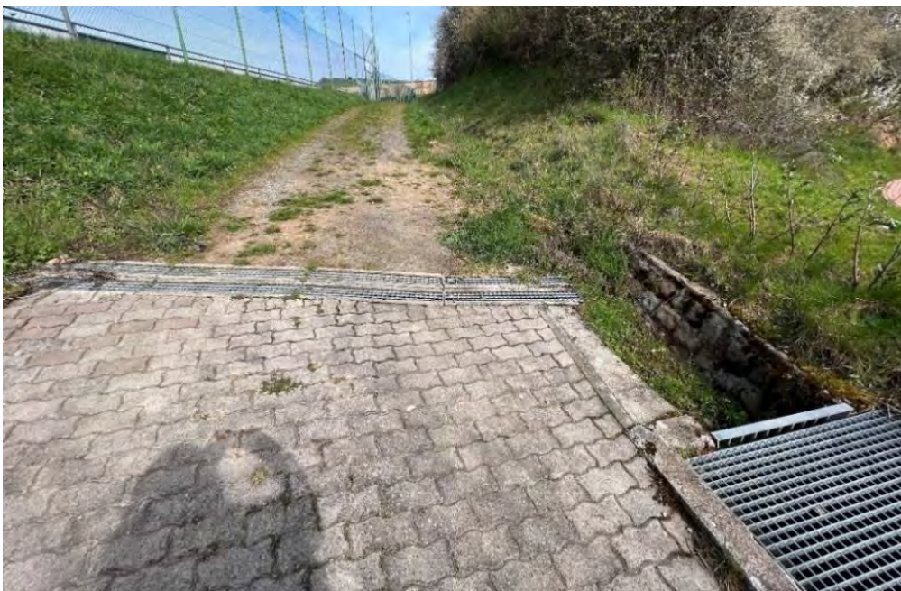
Abb. 120: Unterhaltungsbedürftige Entwässerungseinrichtungen am oberen Ende der Felsenstraße mit Querrinne und Sandfang
