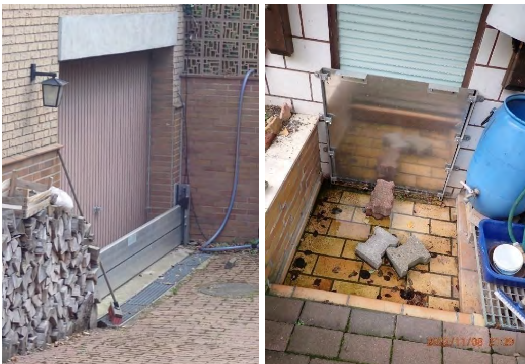
Abb. 20: Dammbalkenverschluss (links) und Schott (rechts)
