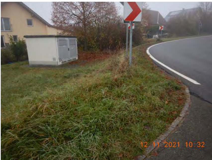
Abb. 92: Exponiert liegende Trafostation in der Kurve der K 31
