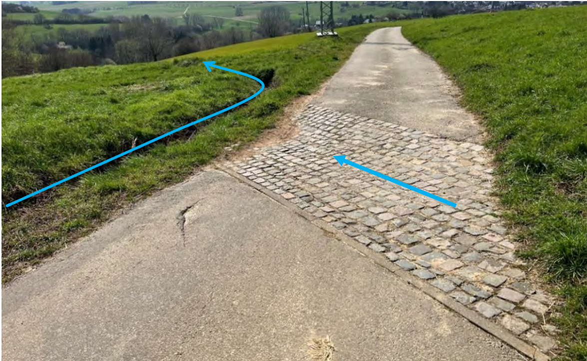
Abb. 57: Gepflasterte Furt mit zugewachsenem Ablauf
