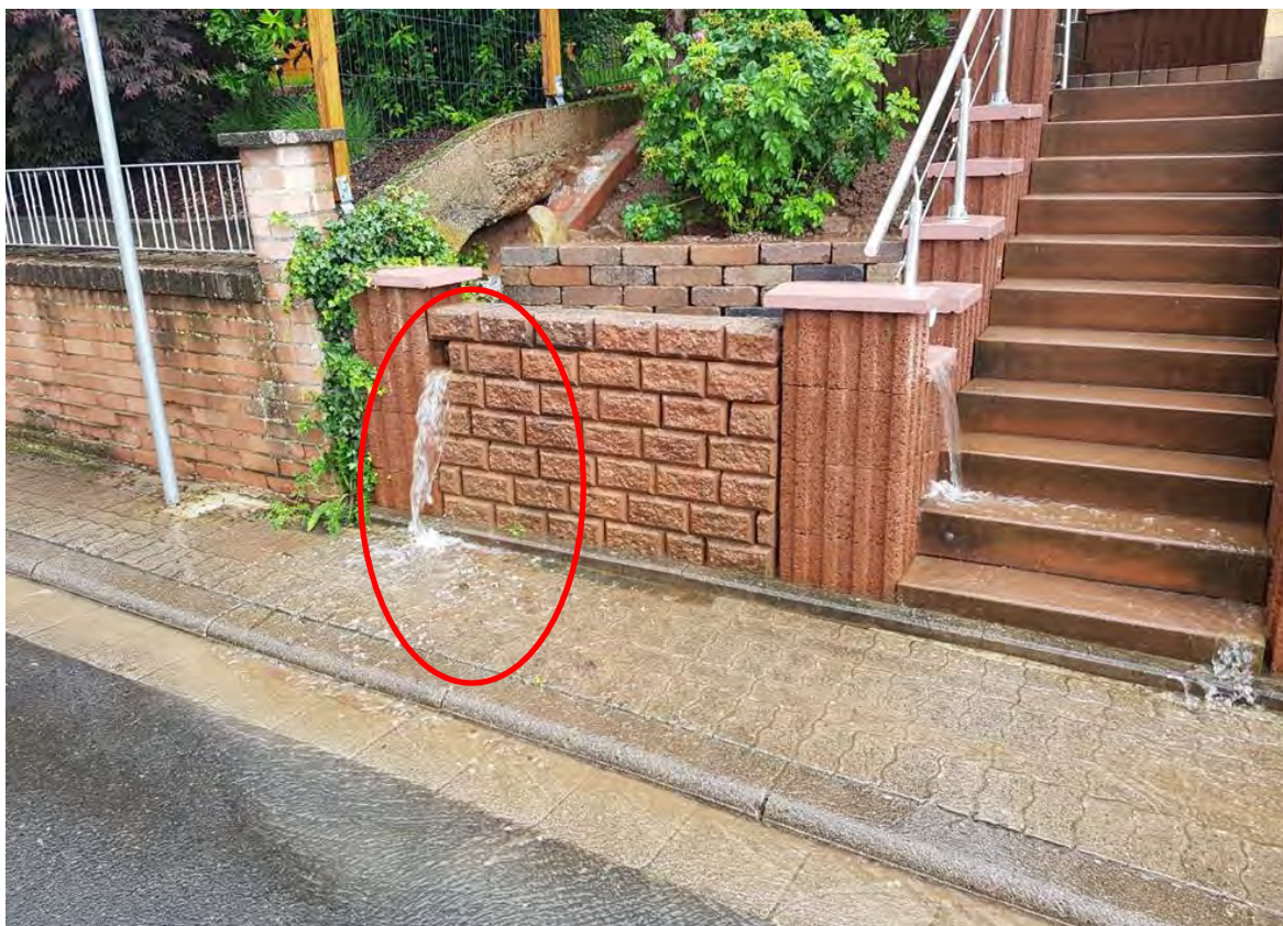
Abb. 125: Wilder Zufluss von Hangwasser über bebautes Grundstück auf die Felsstraße
