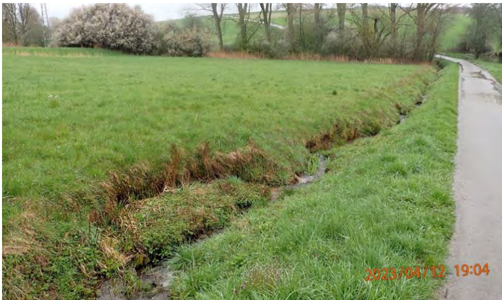
Abb. 48: Erosionsschäden am Sellbach
