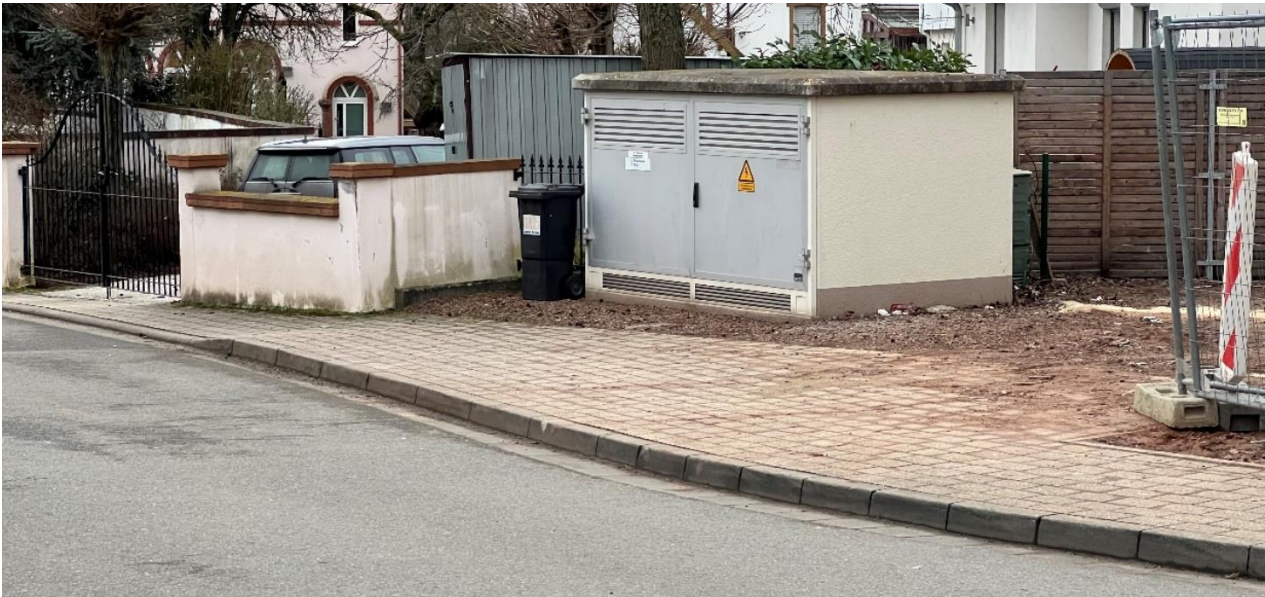
Abb. 98: Überflutungsgefährdete Trafostation Kirchthalstraße
