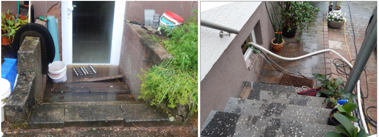
Abb. 32: Überflutung in der Hauptstraße 2016, Foto Klempert
