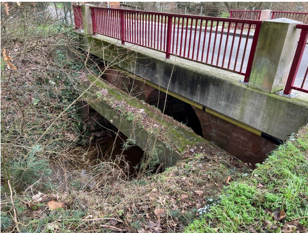
Abb. 33: Brücke Hauptstraße mit abflussbehindernden Einbauten
