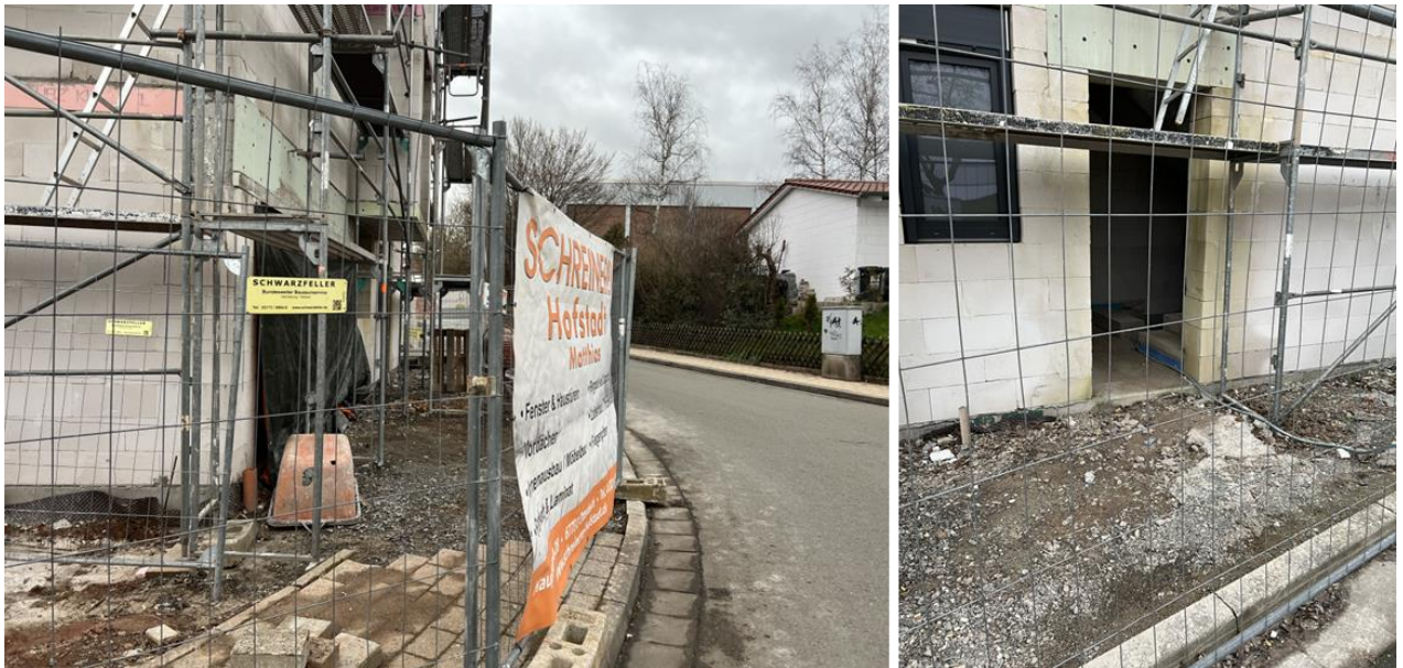
Abb. 99: Überflutungsgefährdeter Neubau (2023) in der Kirchthalstraße
