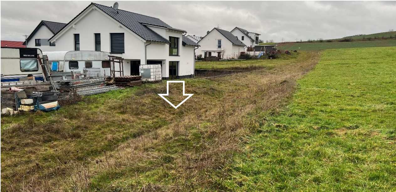
Abb. 23: Abfangegraben zum Schutz vor wild zufließendem Außengebietswasser
