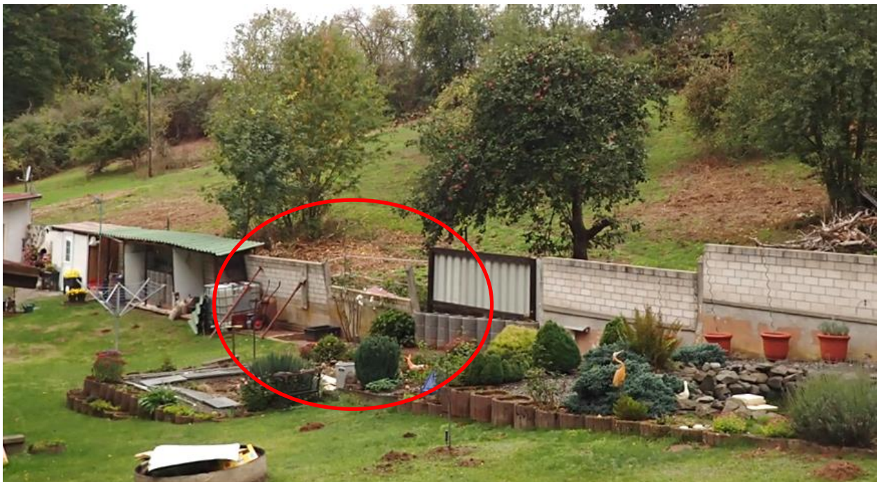
Abb. 111: Einfriedungsmauern quer zur Abflussrichtung mit Durchbruch nach Starkregen
