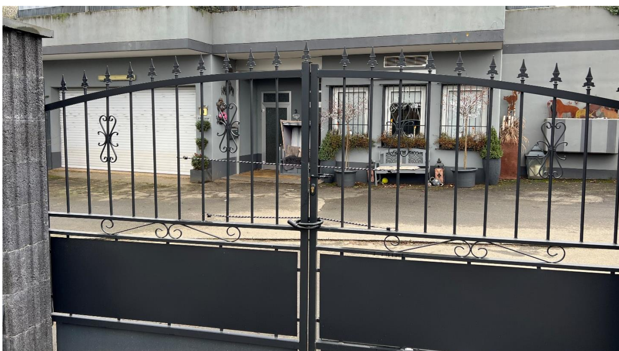
Abb. 58: Beispiele für potenziell überflutungsgefährdete Gebäude
